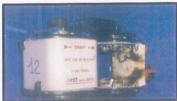
Acima temos um fusível que explodiu por causa de um curto circuito elevado, devido a falta de compactação da areia e umidade.
